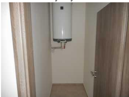
komora s bojlerem
